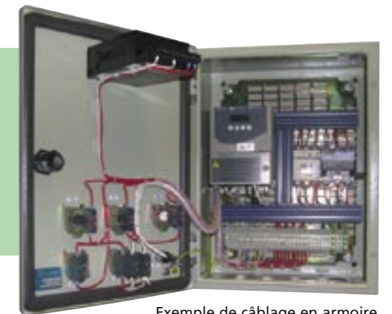
Exemple de câblage en armoire
